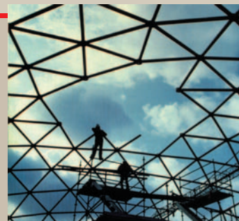
La Géode casi completa. Este domo de Buckminster Fulleresque, construido en París en 1985, utiliza 1.670 triángulos de acero.
